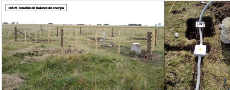
25/04/2019. Avances en la obra civil para la construcción de cercos y bases de torres-2da ETAPA
